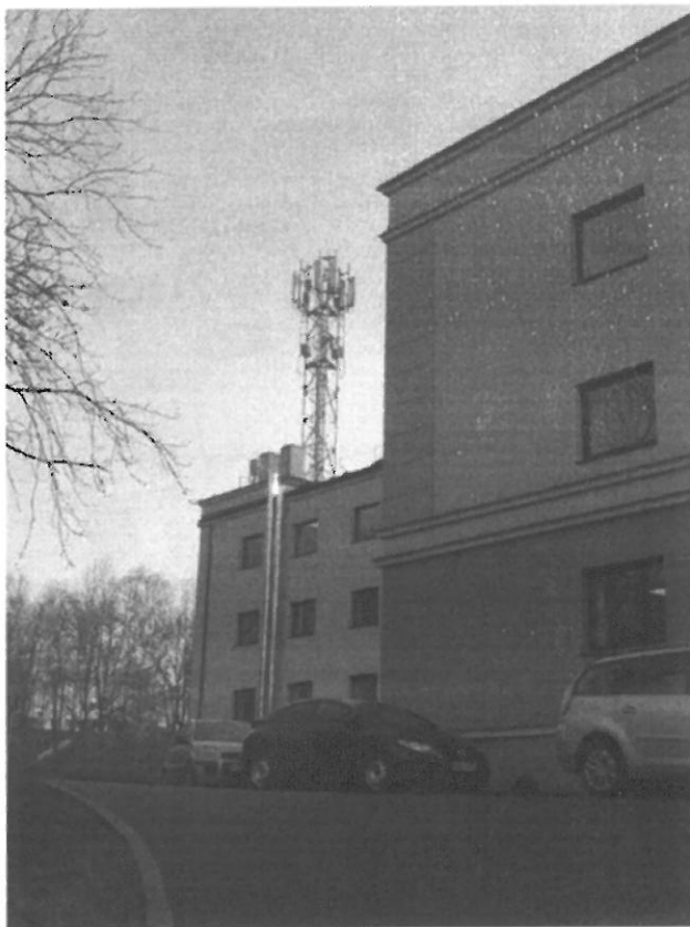
Widok obiektu wraz z zainstalowanym zespołem antenowym
