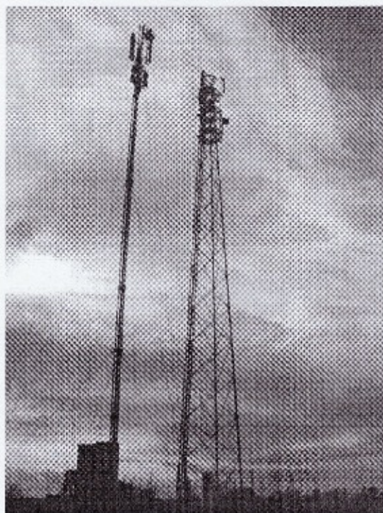
Zof. nr 1): Widok ogólny Instalacji radiokomunikacyjnej.
