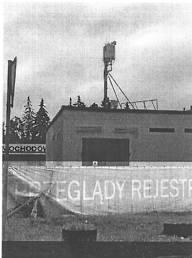
Zał. nr 1: Widok ogólny instalacji radiokomunikacyjnej.
