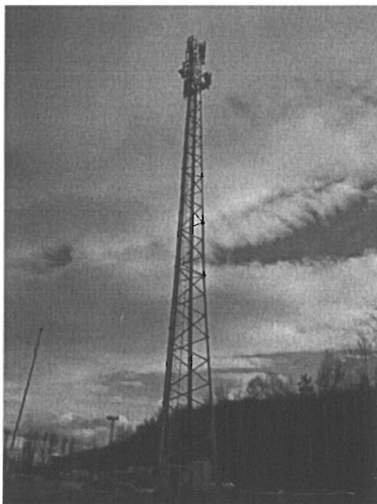
Zał. nr 1: Widok ogólny instalacji radiokomunikacyjnej.
