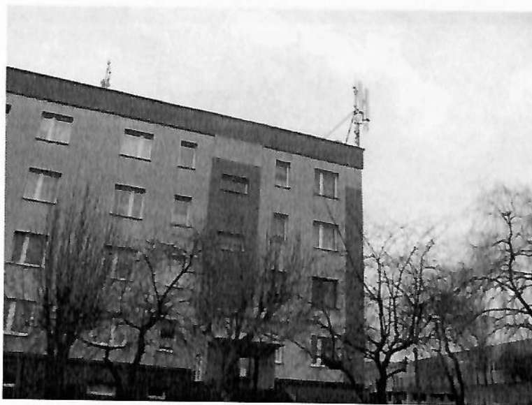
Załącznik nr 1: Widok ogólny instalacji radiokomunikacyjnej.
