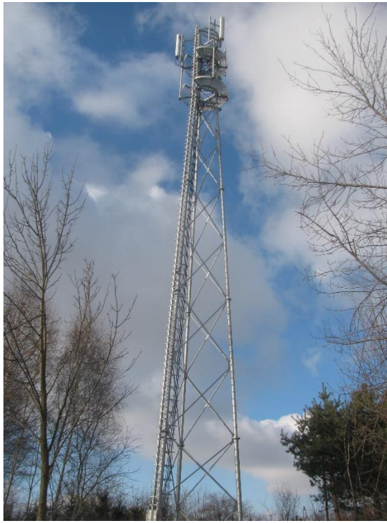
Zał. nr 1: Widok ogólny instalacji radiokomunikacyjnej.
