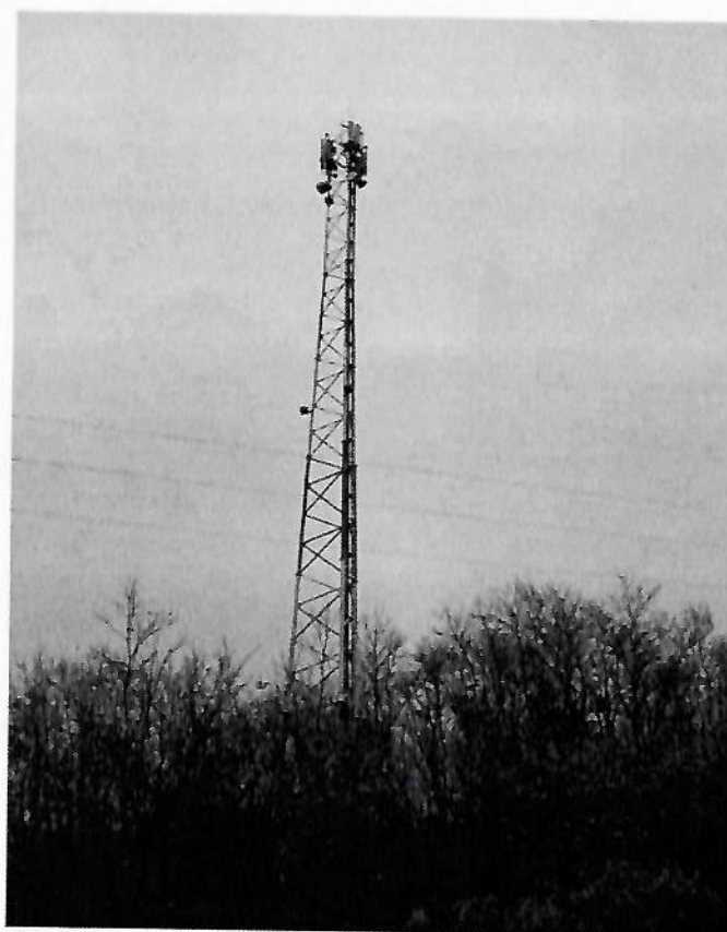
Zał. nr 1: Widok ogólny instalacji radiokomunikacyjnej.
